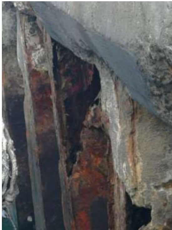
Figuras 14-15. Deterioro de Tablaestaca. Socavación interna Fuente: Manrique Quirós Luque
