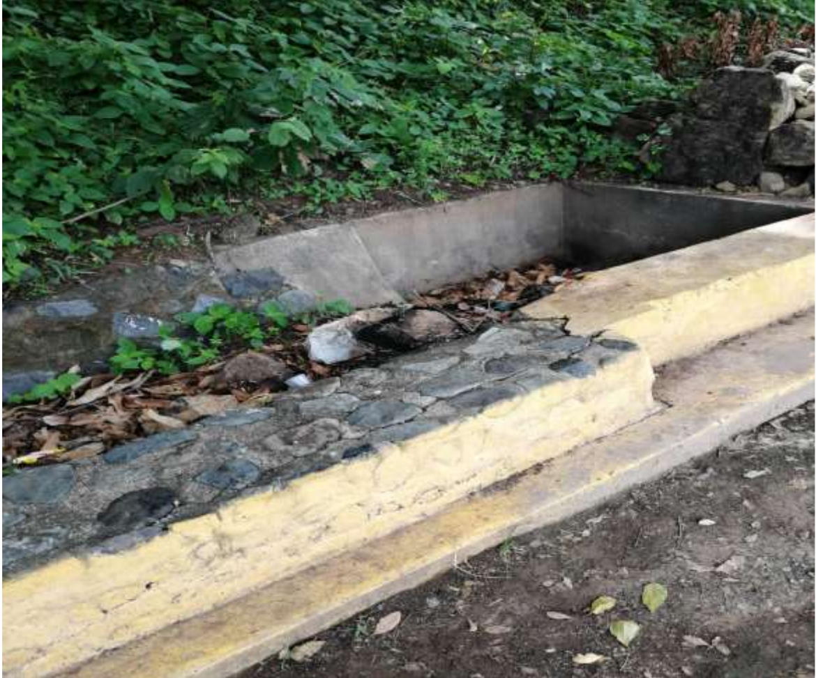
Figura 43. Situación actual de cuneta al pie de la ladera
